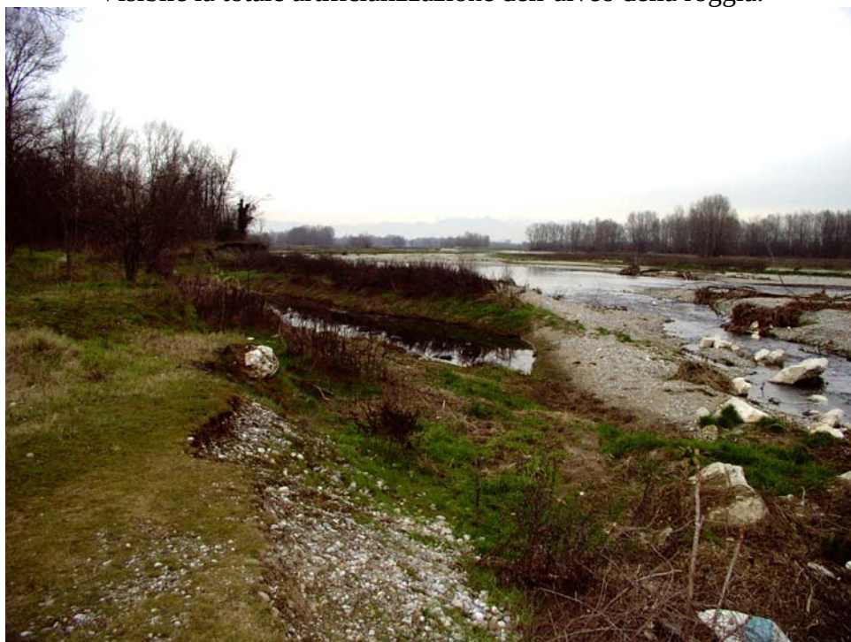
Alveo del fiume Serio nel tratto posto al limite settentrionale del comune. Erosione laterale del tratto terminale della scogliera realizzata recentemente.
