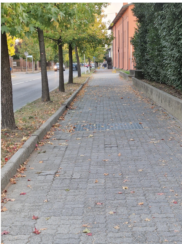
CICLABILE ESISTENTE: SISTEMAZIONE DELLA COMPLANARITA' DEL PAVIMENTO IN AUTOBLOCCANTI
