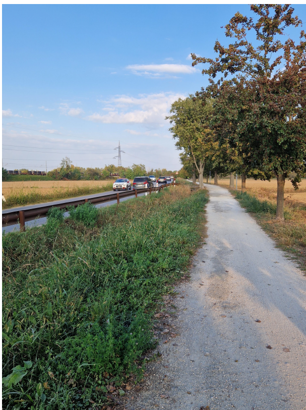
PARTI CENTRALI DEL PERCORSO IN CALCESTRE RAPPEZZI IN CEMENTO
