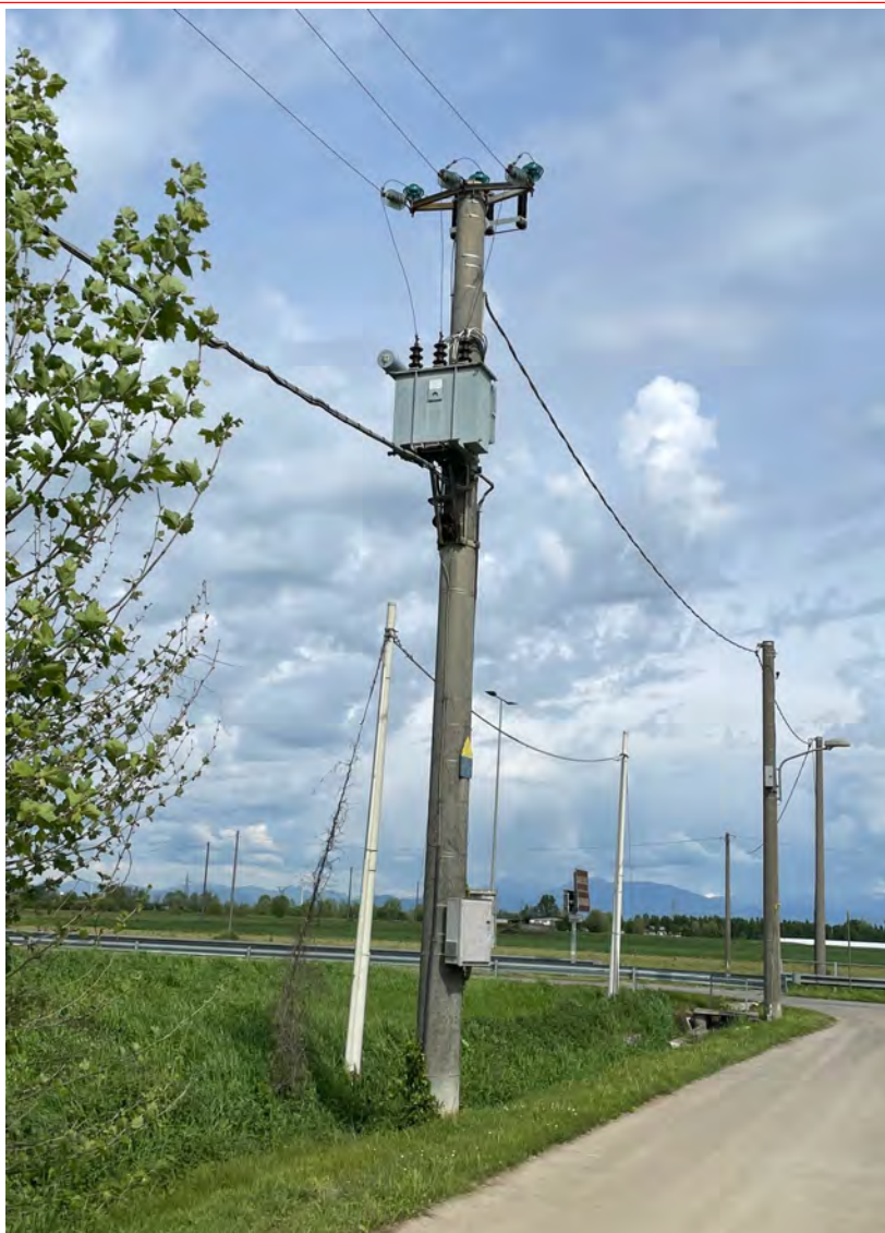
FotoLinea elettrica aerea di media e bassa tensione parallela alla strada consortile lato ovest.
